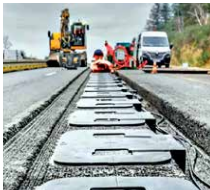
Η υποδομή ασύρματης φόρτισης που έχει τοποθετηθεί σε τμήμα του αυτοκινητόδρομου Μπρέσιας - Μιλάνου αποτελείται από χάλκινα πηνία που είναι συνδεδεμένα με ηλεκτρικό ρεύμα υψηλής ισχύος.
